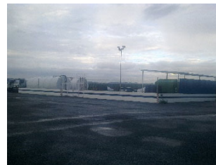
Instalaciones portuarias para el almacenamiento temporal de residuos, con bombas de gran potencia, skimmers, tanques, cubetos, ...
